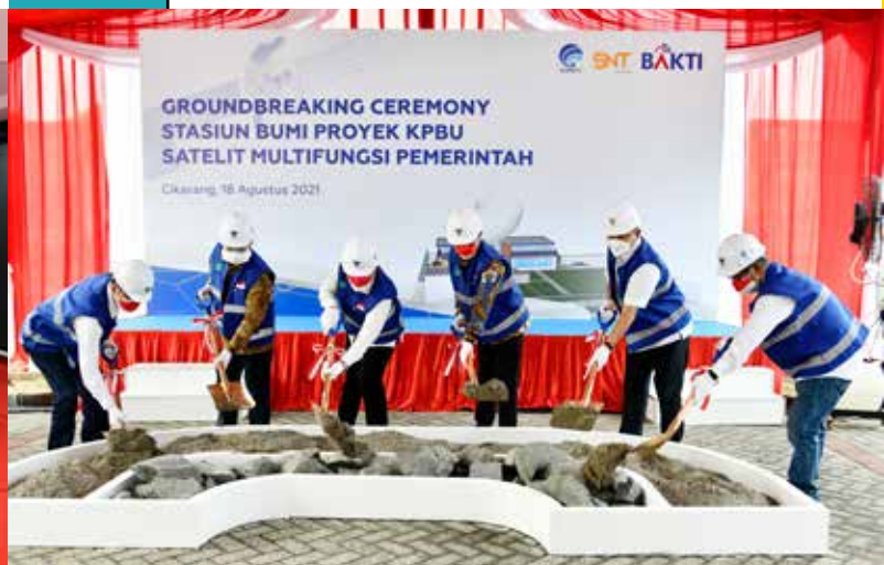
Peletakan batu pertama (groundbreaking) Stasiun Bumi Satelit Multifungsi (SMF) Satelit Republik Indonesia atau SATRIA-I, di kawasan perkantoran PT. Pasifik Satelit Nusantara (PSN) Cikarang, Jawa Barat, Rabu (18/08/2021).
